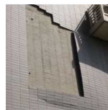
墙砖渗水脱落
